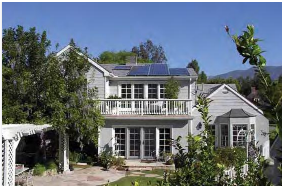
Instalación solar fotovoltaica doméstica de Martifer Solar en Pasadena, California.
