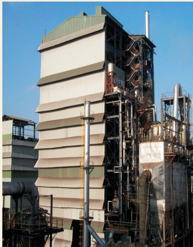
Tecnología Ausmelt, similar a la que será instalada en el Complejo Metalúrgico Vinto.
