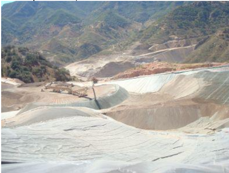
Area de lixiviación, donde se pueden observar las membranas plásticas. Foto: vozenred.com
